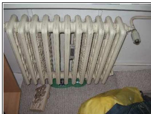
Otopné těleso v bytě
