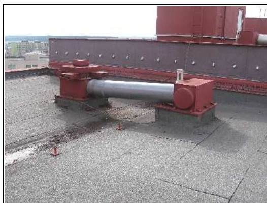
Odvětrání instalační šachty a centrální ventilátor
